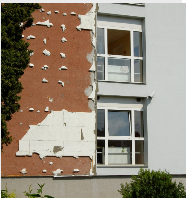
A szélszívás komoly építési károkat okozhat, ha nem készülünk fel ellene.
